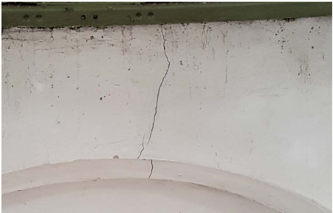
Bild 62: Riss im Ursprungsmauerwerk über dem oberen zugemauerten Fenster
