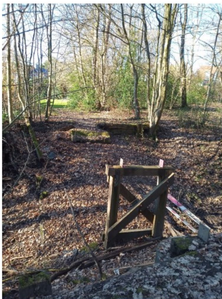
Abbildung 2: Zustand der Fundamente und des mittleren Holz-Pfeilers am 16.02.2025.
