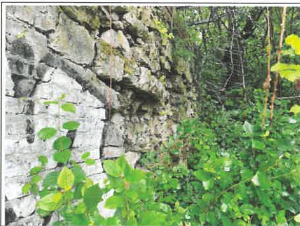
Bild 13: Ausbruchstelle in der Kalkstein-Verblendung und ...
