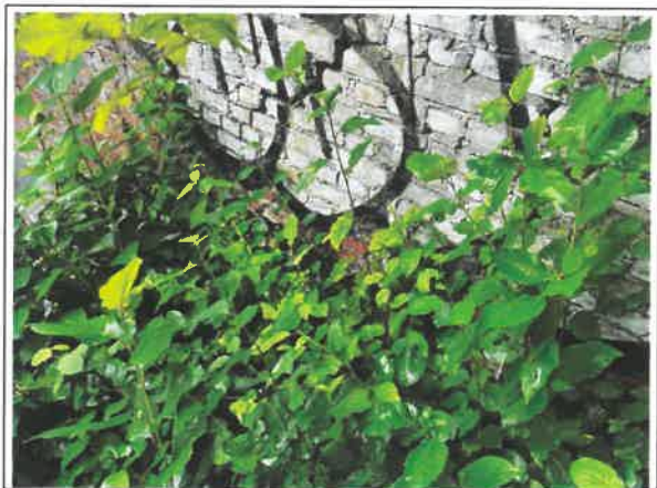
Bild 14: ... massiver Risse-Schaden im Ziegelmauerwerk.
