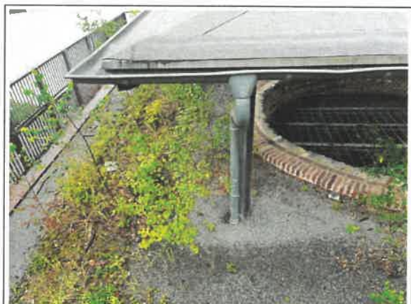
Bild 8: Im Splittuntergrund verschwindendes Fallrohr der Dachentwässerung.
