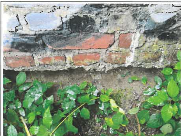
Bild 17: Unterhöhlte Mauerschale. Der Hohlraum erstreckt ...
