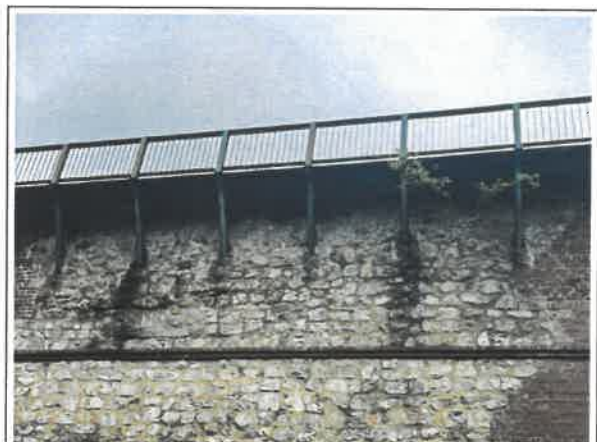
Bild 10: ... im Bereich der Trägereinbindungen.
