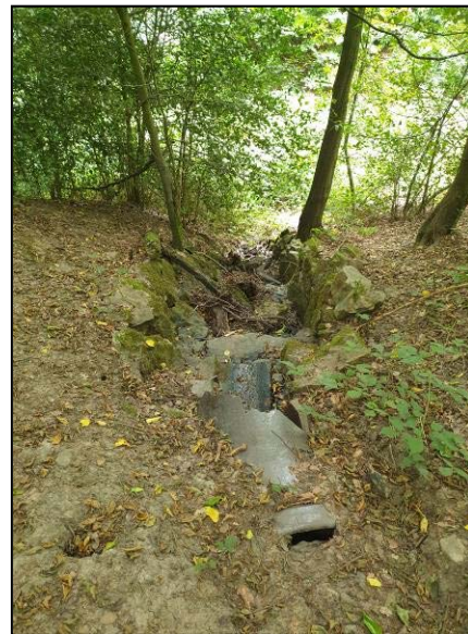
Abb. 13: Stark beschädigter Rohrdurchlass unter unbefestigtem Weg
