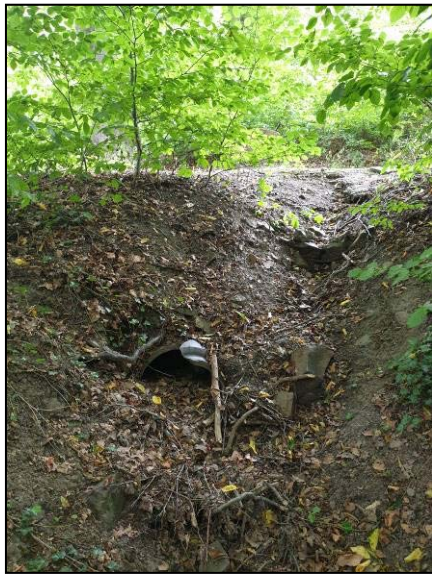
Abb. 12: Stark sedimentierter Rohrdurchlass (Querschnittsreduktion)
