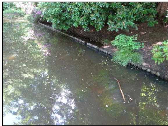
Abb. 19: Umspülter Uferverbau des „Achterteichs“ (Rundpalisaden)
