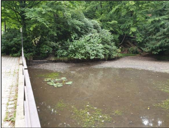
Abb. 14: „Achterteich“ mit geringem Wasserstand und sichtbarer Volumenreduktion durch Schlamm-schicht
