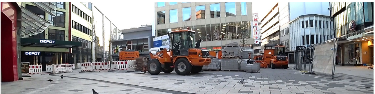
Abb. 6: Auch das Baustofflager steht als „Kinderspielplatz“ innerhalb der Fußgängerzone sperrangelweit offen.
