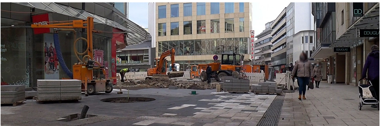
Abb. 2: Ein abgesperrter Baustellenbereich ist –aus Bequemlichkeit?– nicht vorhanden. Wie sich hier mobilitätseingeschränkte Passanten zurechtfinden sollen – insbesondere Blinde –, bleibt ein Geheimnis.
