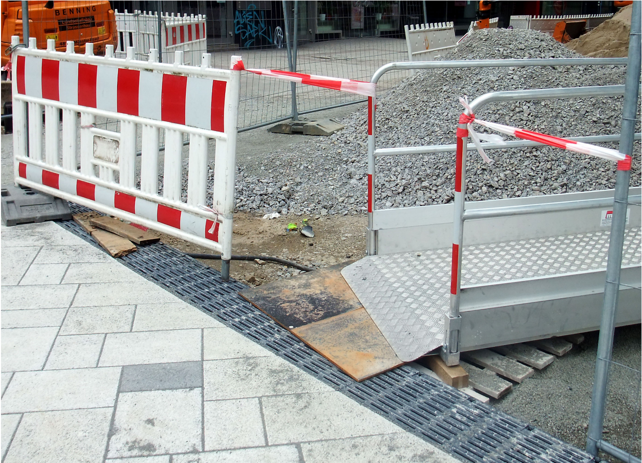
Abb. 7: Flutterband hat als Absperrung nichts auf Baustellen zu suchen. Blinde orientieren sich mit ihrem Stock auf Bodenebene – nur ist auf dieser Ebene kein Flutterband, das blinde Passanten warnen könnte. Und auch hier fehlt wieder die Fußplatte.
