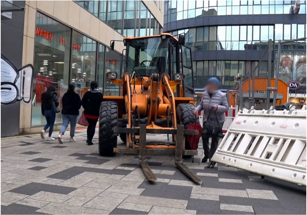
Abb. 3: Bagger im Weg, Absperreinrichtungen sind irgendwo lose angelehnt, ältere Passanten müssen über Staplergabeln klettern. Ein abgesperrter Baustellenbereich ist nicht vorhanden.
