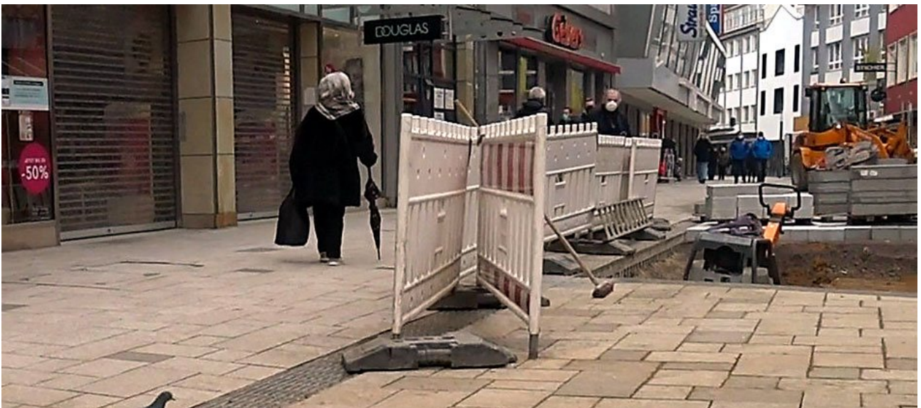
Abb. 4: Absperr- und im speziell die aufgestellten Absturzsicherungen sollen tatsächlich vor Abstürzen sichern. Hier sind die lediglich Sichtblenden für einen Teil der Baustelle, in die man mit eingeschränkten Sehfähigkeiten leicht in die Baugrube fällt, ...
