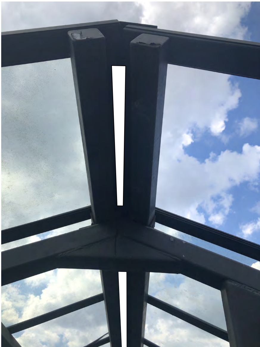
Lineare LED-Lichtarmatur mittig entlang der Dachkonstruktion.
