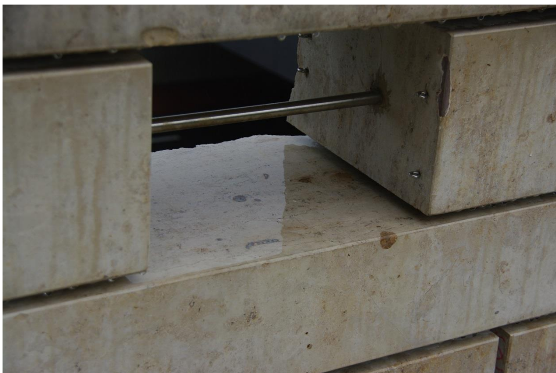
Foto 45: deutlicher Wasserfilm auf der Mauerstein-Oberfläche an der Spiegelung erkennbar
