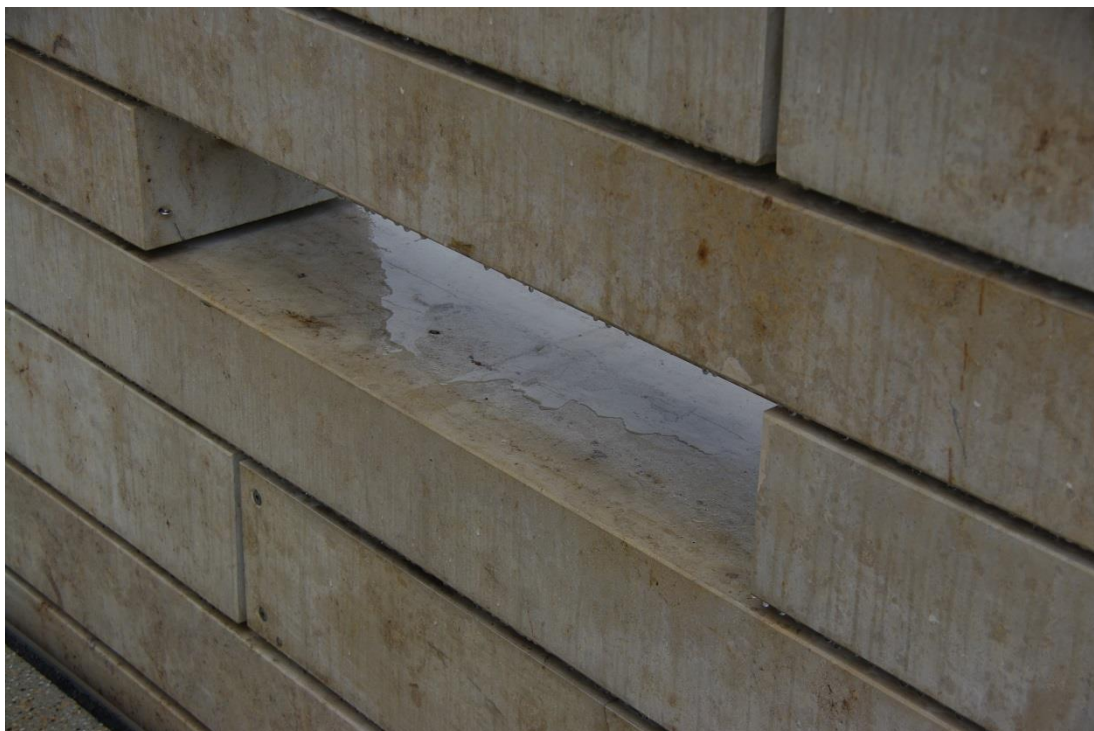
Foto 44: deutlich erkennbarer Wasserfilm auf der Mauerstein-Oberfläche
