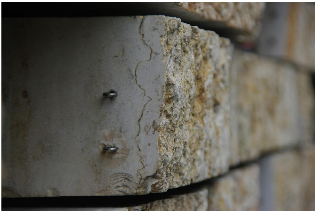
Foto 38: an der Oberfläche erkennbare Stylolithen setzt sich auf der Stirnseite des Mauersteins fort
