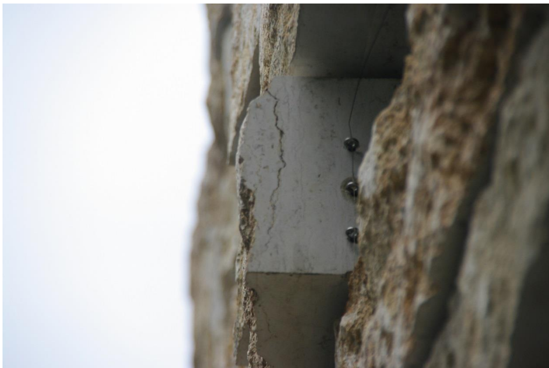
Foto 39: an der Oberfläche erkennbare Stylolithen setzt sich auf der Stirnseite des Mauersteins fort; deutliche Aufweitung im oberen Bereich
