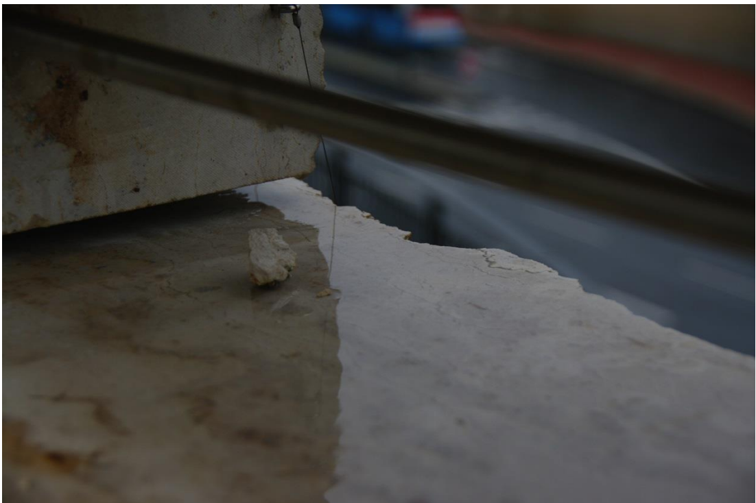
Foto 47: deutlicher Wasserfilm auf der Mauerstein-Oberfläche an der Spiegelung erkennbar
