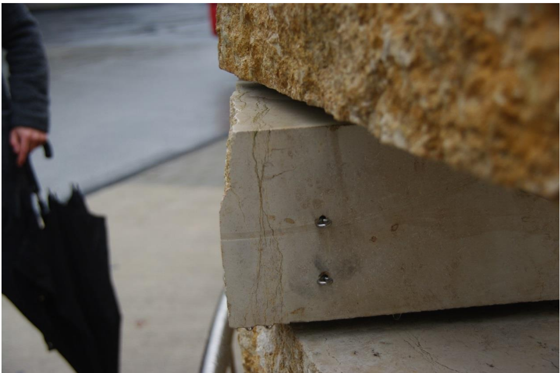
Foto 37: an der Oberfläche erkennbare Stylolithen setzen sich auf der Stirnseite des Mauersteins fort
