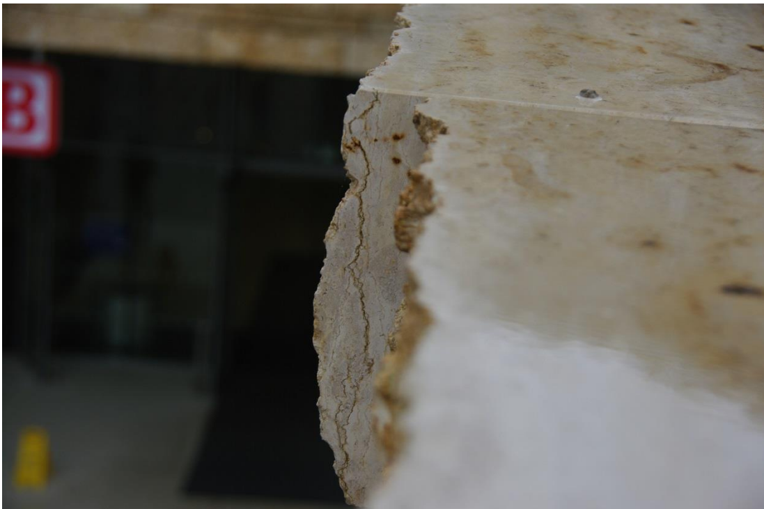
Foto 35: an der Oberfläche erkennbare Stylolithen setzt sich auf der Stirnseite des Mauersteins fort
