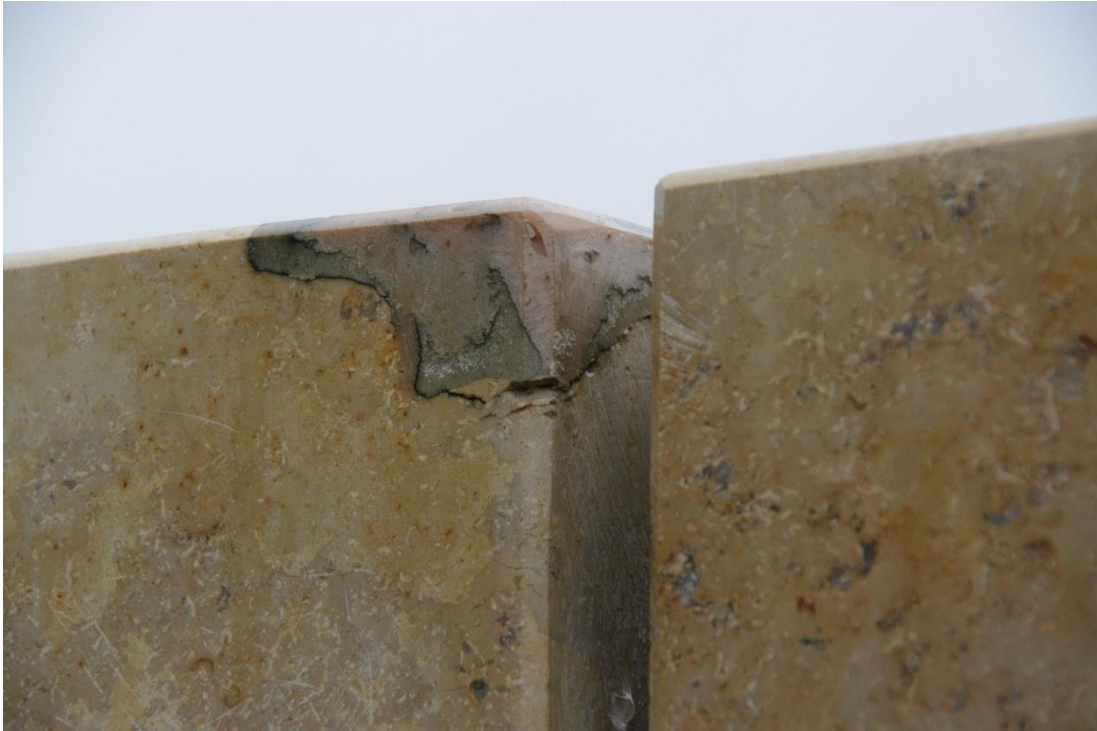
Foto 40: Spachtelung an einer Ecke eines Mauersteins; Reparaturstelle bereits teilweise abgerissen / abgelöst
