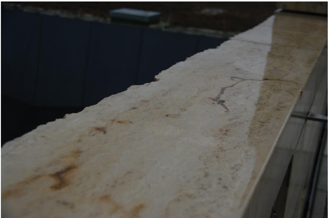
Foto 46: deutlicher Wasserfilm auf der Mauerstein-Oberfläche an der Spiegelung erkennbar
