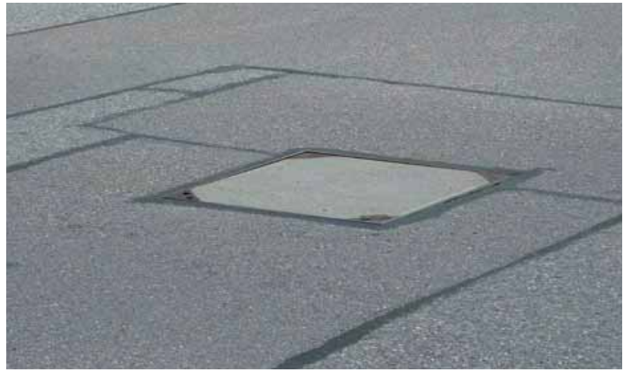
Flickstellen infolge Leitungsgrabungen (ADAC)
