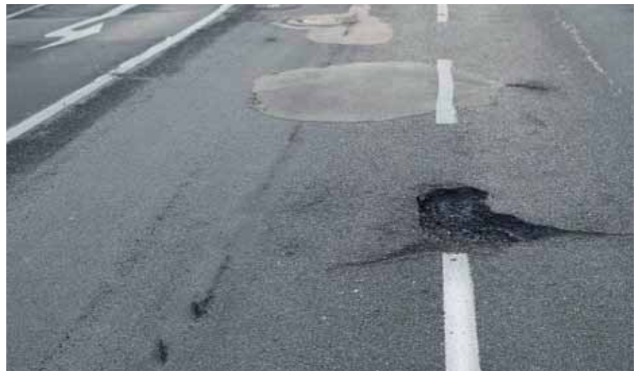
Aufbrüche und Flickstellen
