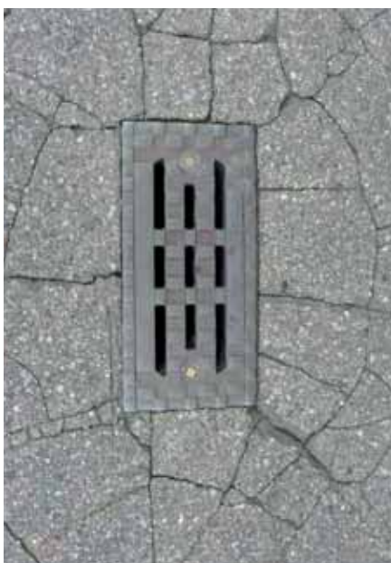
Hochauflösende Kameras ermöglichen das Erkennen von Rissen ab 1 mm (ADAC)
