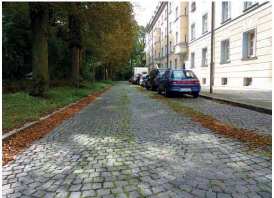
Spurrinnen aufgrund nicht angepasster Bauweise (ADAC)
