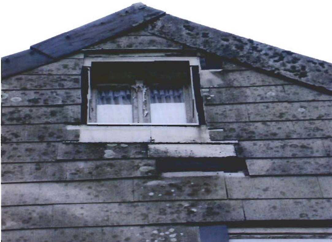
Bild 7: Zustand der westlichen Fassadenbekleidung. Die Bauteilanschlüsse sind offen. Die Anschlüsse und Flächen teilweise nicht mehr regensicher
